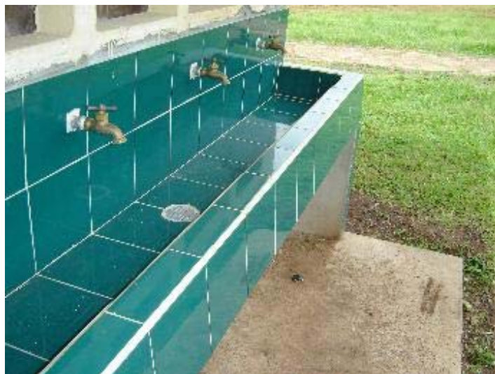
Fotos 25. Lavamanos escolares.
