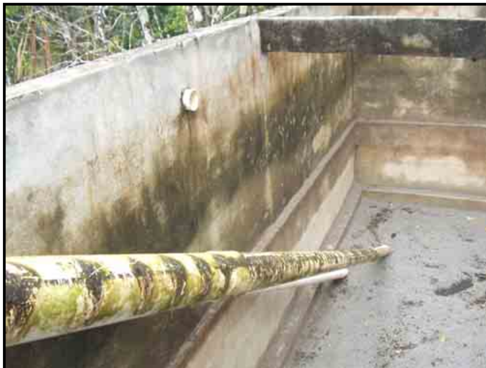
Figura No. 4.2.4.1.4-3 La estructura actual de entrada de agua al Filtro Lento evaluado
