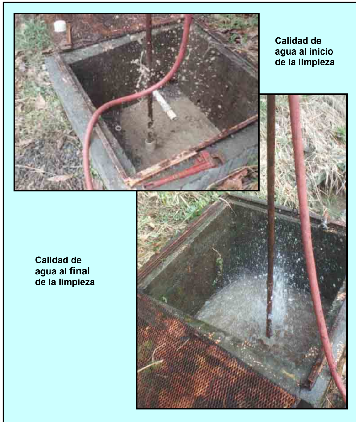
Figura No. 4.1.4-1 Cambio notorio de la calidad de agua, producto de una limpieza con aire comprimido y tratamiento con agentes dispersantes químicos, (HidroGeo Servicios)
