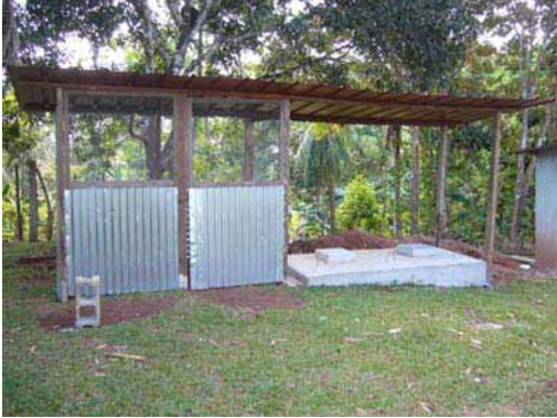
Fosa de tratamiento en la escuela de Los Hules Abajo, un esfuerzo por mejorar las condiciones de saneamiento de esta subcuenca
